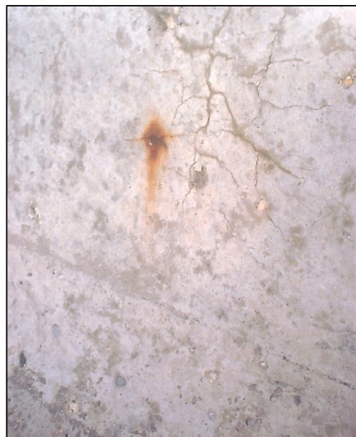
Slika 2.3.1.2.2::3 Pojava smeđih mrlja na betonu
