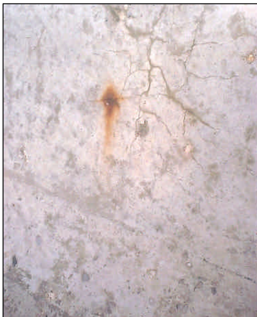
Slika 4.3.1.2.2::3 Pojava smeđih mrlja na betonu
